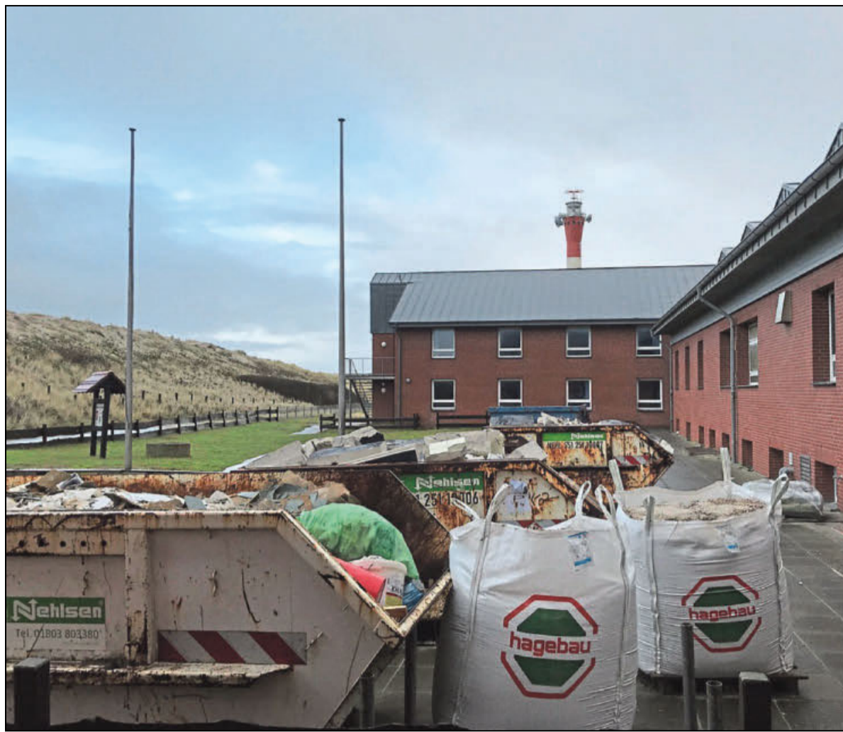
Bei den Abbrucharbeiten fiel reichlich Bauschutt an. Die großen Mulden auf dem Vorplatz des Heims sind aber mittlerweile alle wieder verschwunden.
